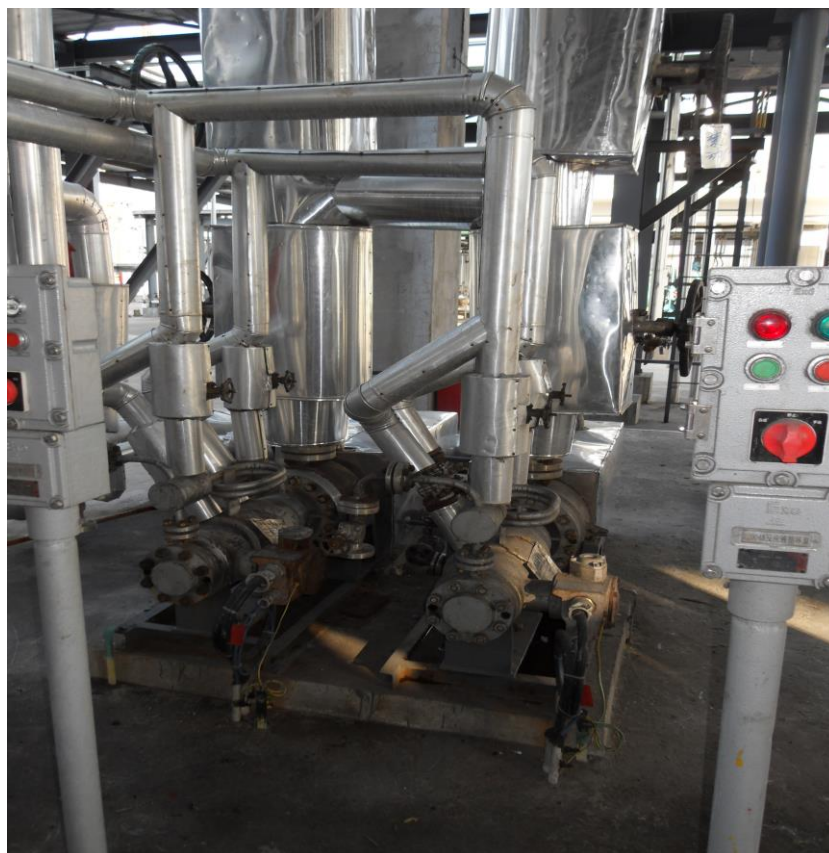
组图二 为 5 万吨/年规模碳酸二甲酯配套 6 万吨/年碳酸丙烯酯装置
